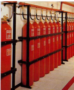
IMPIANTI A GAS INERTI
